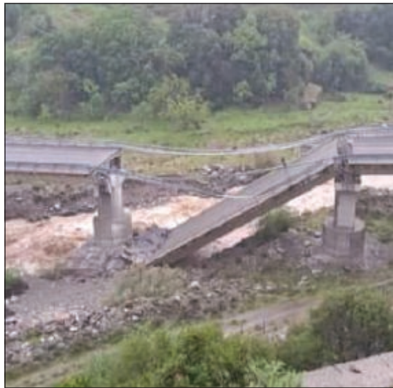
Il viadotto crollato
